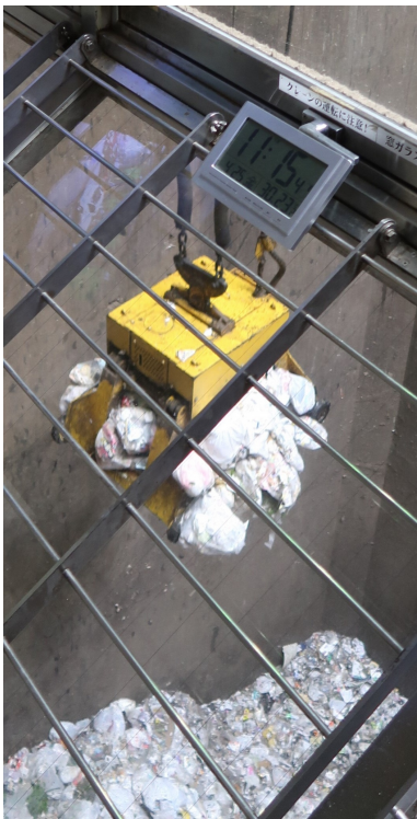
可燃ごみ ごみピット内
