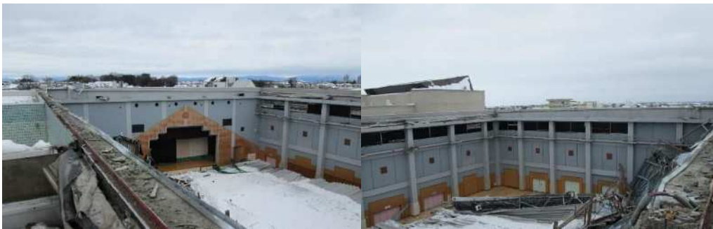
写真 市民総合体育館屋根崩落事故
